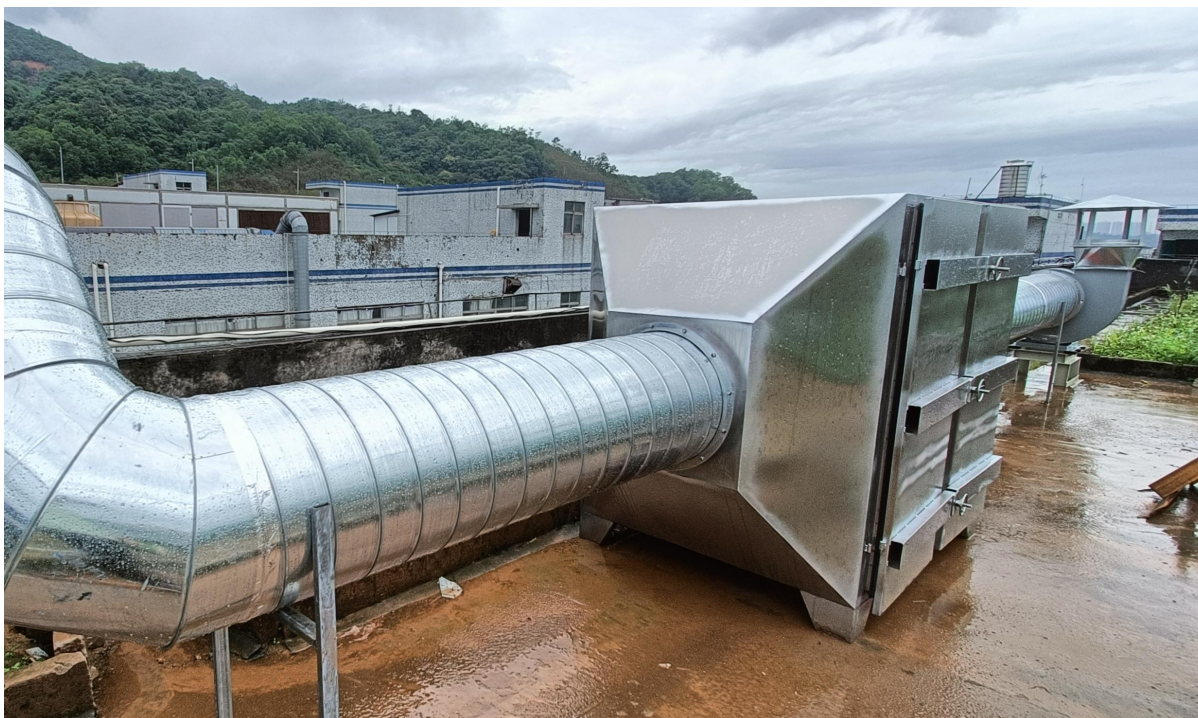
注塑废气：高效蜂窝活性炭吸附装置
