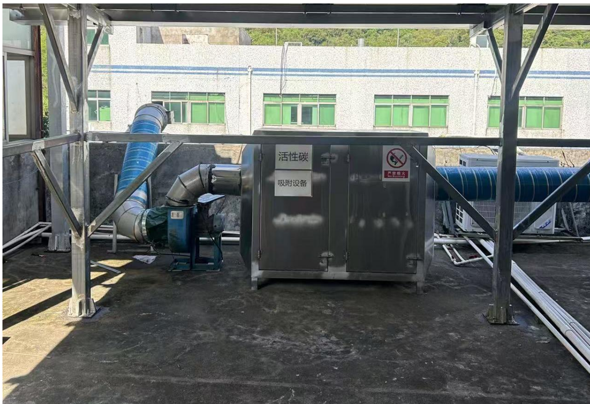
移印废气：高效蜂窝活性炭吸附装置
